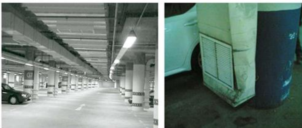
شکل ۱: سمت چپ نمای کلی نازیبای سیستم سنتی کانال کشی جهت تهویه پارکینگ و سمت راست یکی از ایرادات مرسوم در این سیستم ها را نشان می دهند
